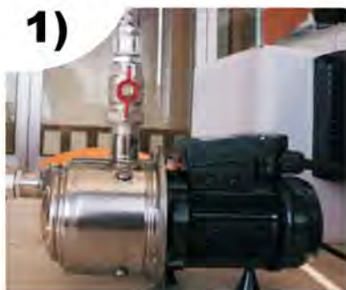
Elettropompa collegata idraulicamente
