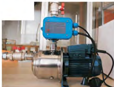
Impianto esistente comandato da controllo di pressione
