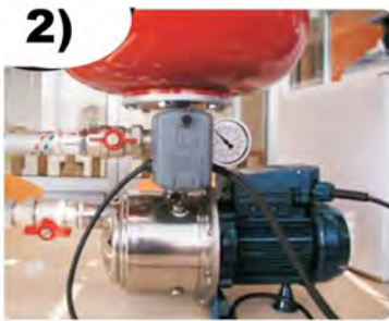
Installation existante avec commande par pressostat
