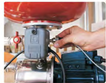
5) Installer le capteur de pression
