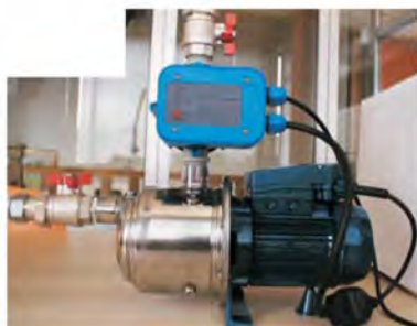
Installation existante commandée par régulateur de pression
