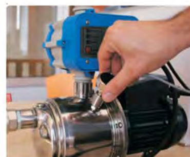
5) Installer le capteur de pression
